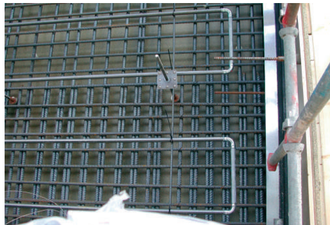
koelleidingen in een betonwand
