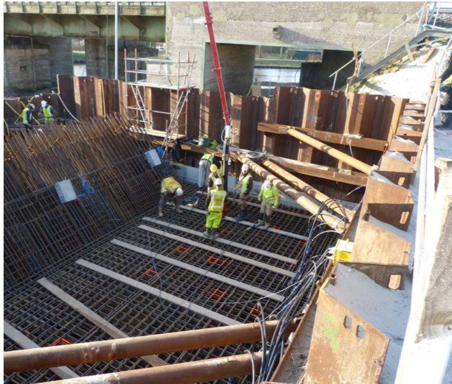
Bij de aanleg van de spoorbrug bij Zuidhorn spelen duurzaamheidsaspecten een rol, zoals de koeling van het beton met kanaalwater.
