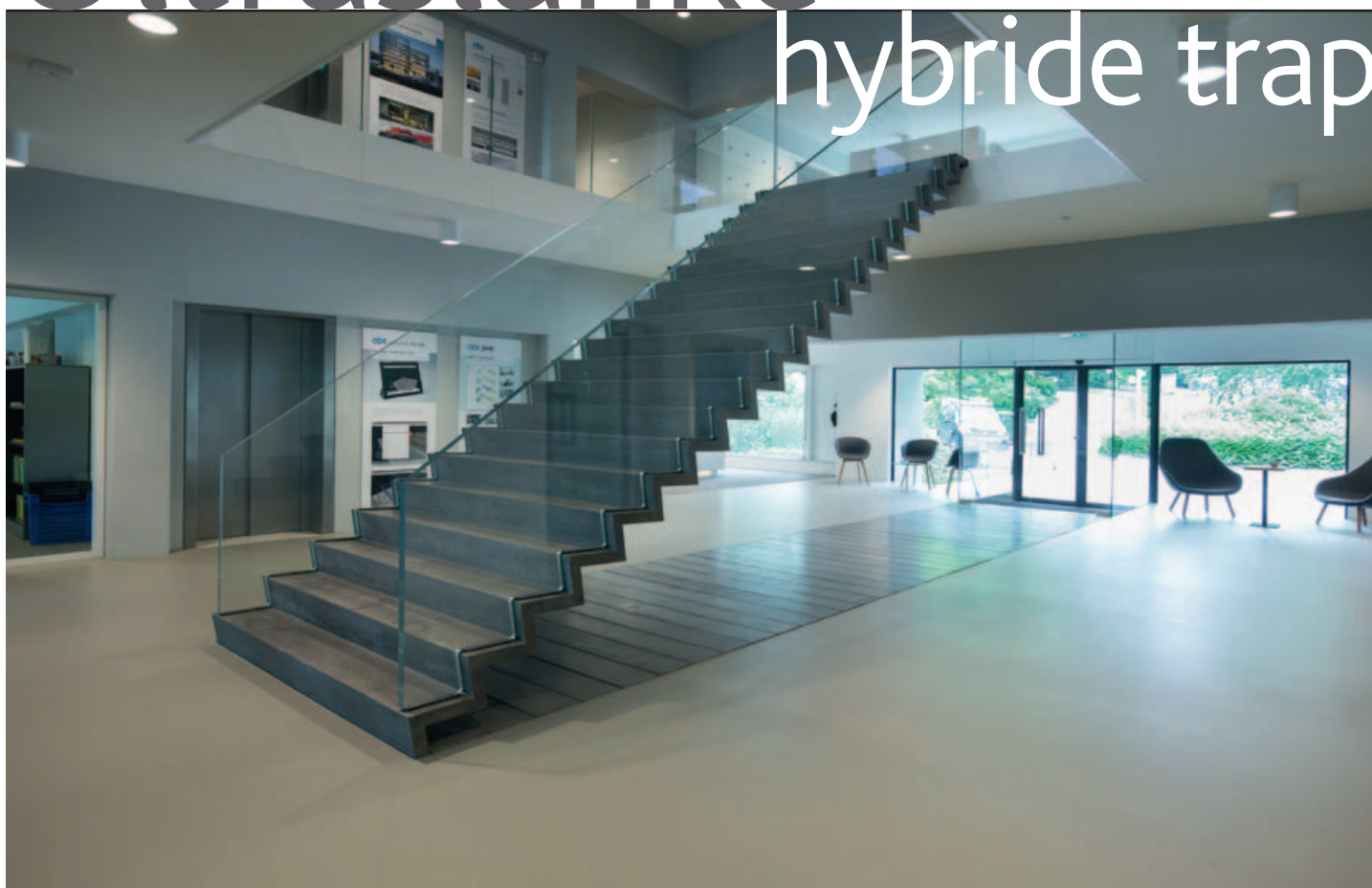
De hybride trap overspant een afstand van bijna 6 meter, zonder ondersteuning of verstijvingsribben. Foto's: Hans Roggen – ABT
