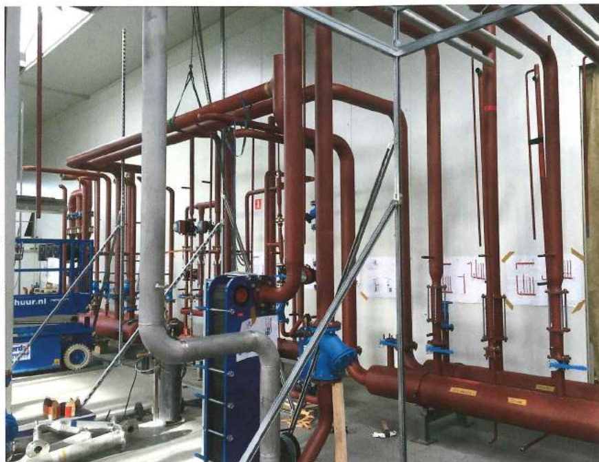
-Figuur 4- De techniekruimte, die hier nog in mockup te bewonderen is
