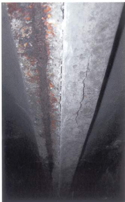
Sterk aangetaste wapening in het kwaaitaalelement.
