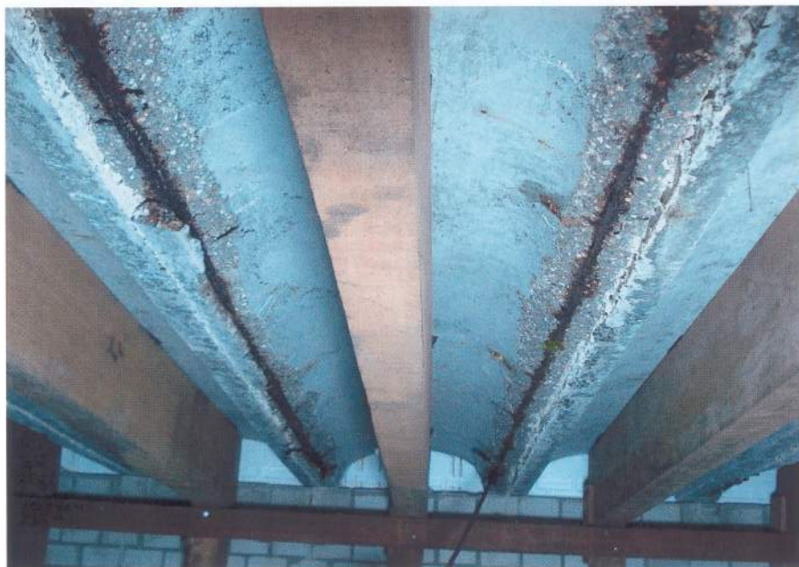
De onderzijde van een kweekvloer met gecorrodeerde wapening.
